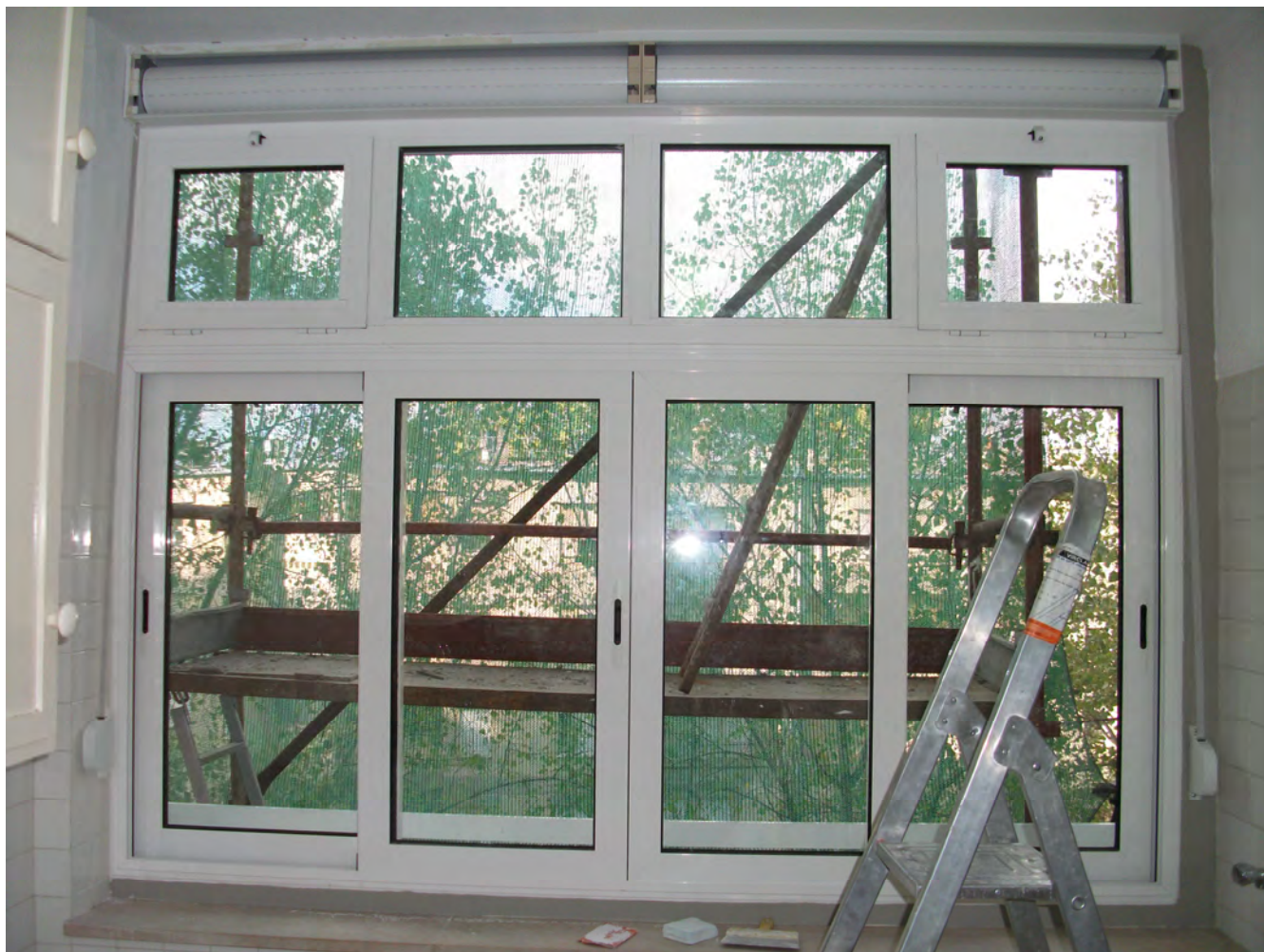
IASFA - Chelas – Substituição de caixilharias Vão com persiana integrada, em fase final de montagem
